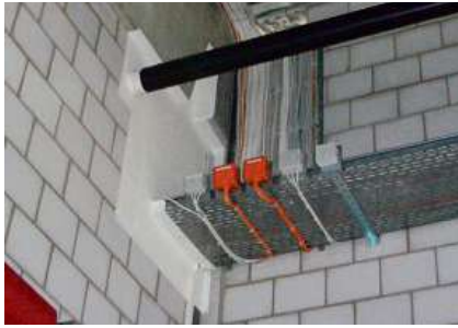
Bild 8 Beispiel grossflächige Durchführung von Metallkanal durch Brandschottung.
