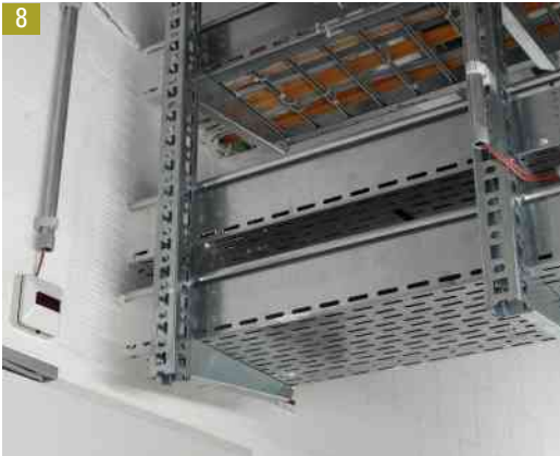
Beispiel Grossflächige Durchführung von Kabeltragsystem durch Brandschottung. (Bild ARNOLD Engineering)
