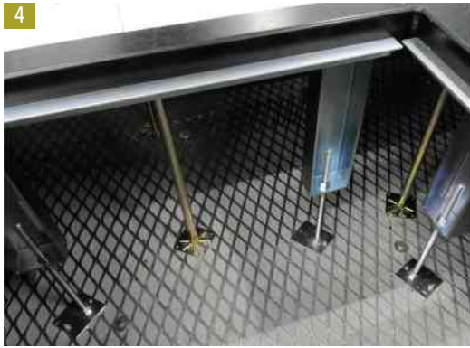
Beispiel einer engmaschigen Potenzialausgleichsanlage (SRPP; Systembezugspotenzialebene nach SN EN 50310) unter Einbezug der Konstruktionen Doppelbodenstützen und Schrankrahmen. (Bild: ARNOLD Engineering)
