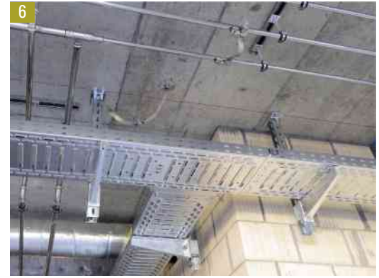
Beispiel Trassen mit grossflächiger Durchgängigkeit (4.4.4.Z1) als Potenzialausgleichsleiter mit Anschluss an Bewehrung (5.4.3). (Bild: ARNOLD Engineering)
