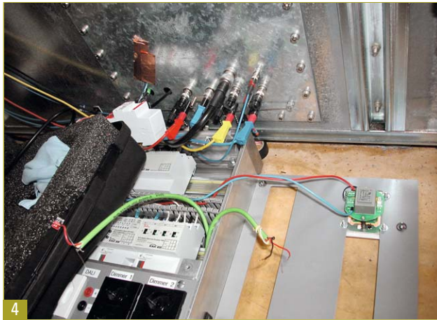
4 Wird der Schirm des KNX-Kabels bei der Einführung in die Absorberkammer geerdet, so können die Feldstärken um ca. 20 dB gesenkt werden und die Störungen, verursacht durch das KNX-Signal, sind nicht mehr sichtbar.
