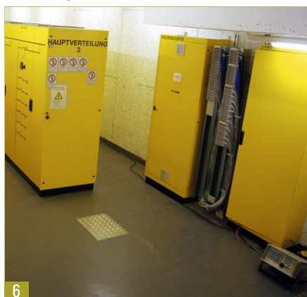
6 Netzanalyse in der Niederspannungshauptverteilung.
