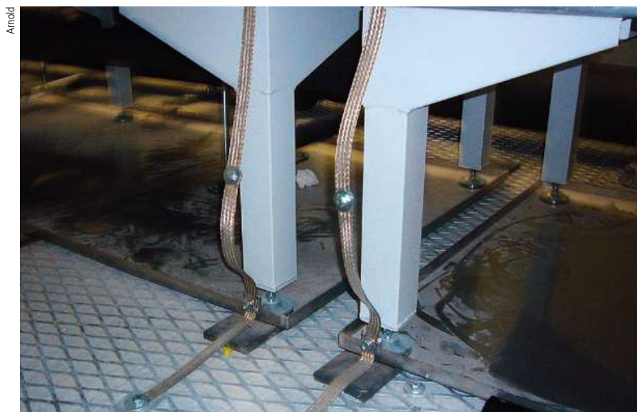
Bild 6 Beispiel von Konstruktionsanschluss (Umluftkühler) mit flexiblem Band an die SRPP.
