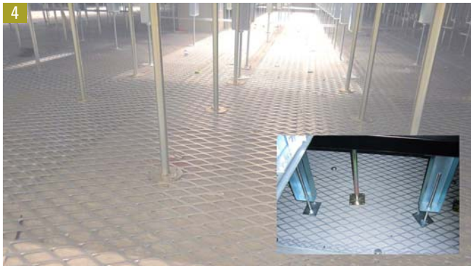
Die Gitterstruktur bildet die Systembezugs-Potenzialebene für sämtliche darauf platzierten Einrichtungen (z. B. Kabelführungssysteme, Bodenrahmen, Verteilschränke, Geräte HLKS-Systeme und Doppelbodenstützen).
