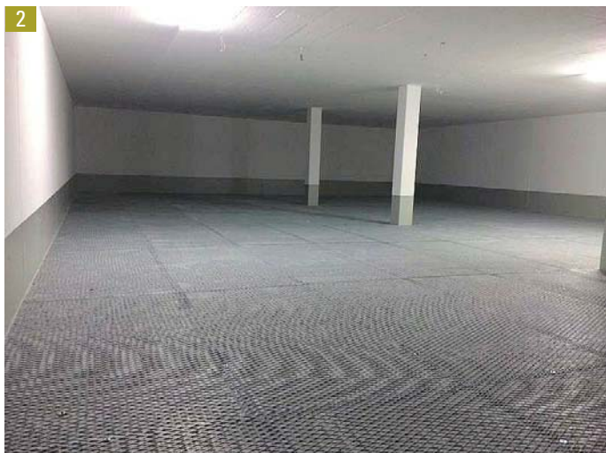
2 Grossflächig verlegte Systembezugs-Potenzialebene mit Stossüberlappungen in einem Rechenzentrum.
